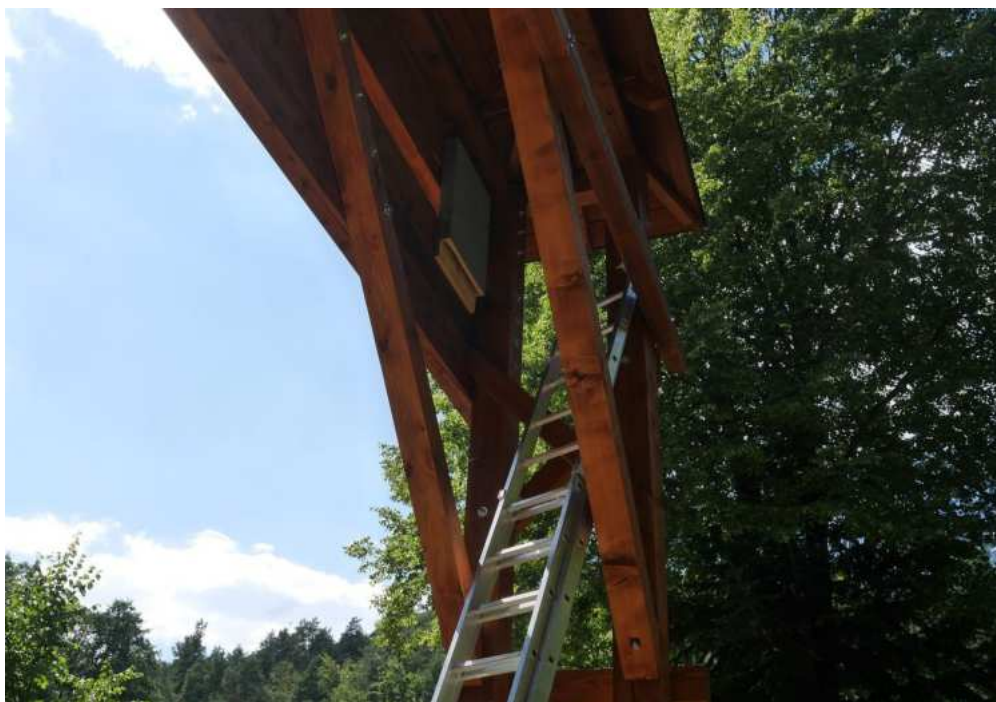
Vstupná brána do Lačnovského kaňona – drevená konštrukcia vysokej vstupnej brány poskytla taktiež priestor pre inštaláciu búdky pre početnú kolóniu netopierov (Lipovce, SKUEV Kamenná baba, SK).
